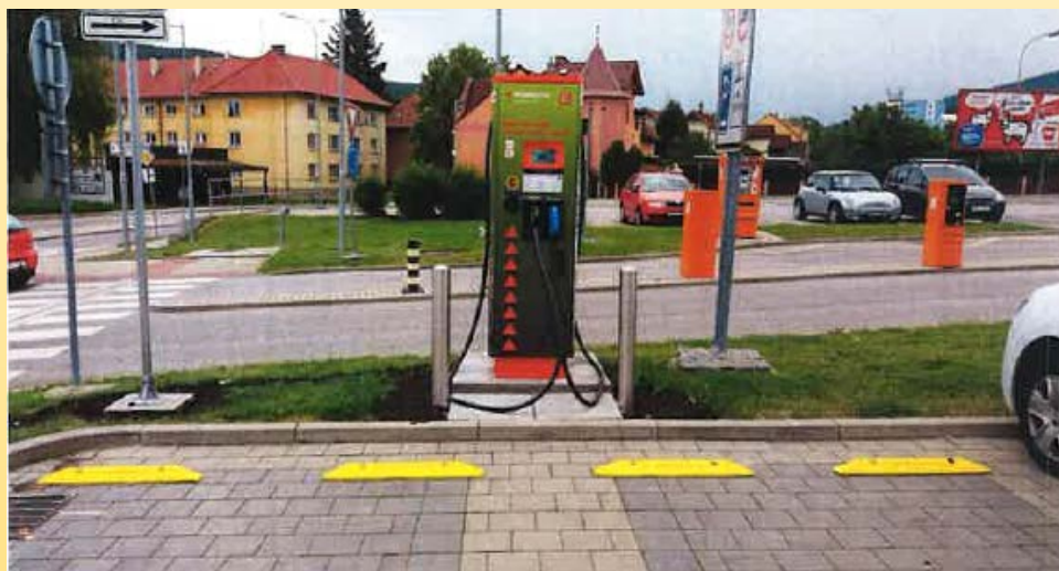
Mechanické zábrany car-stop proti nárazu do nabíjecí stanice
